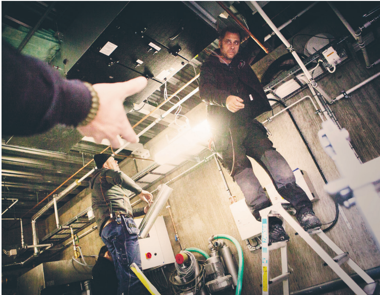
KOMPLEXT. Många komponenter ska samverka för att styrningen av ventilationen i biltvätten på nya Statoilmacken ska fungera. "Ofta får man improvisera", säger Björn Haldin, ventilationsmontör på Henriksbergs Verkstäder. FOTO: JOHANNES LJLJESON
